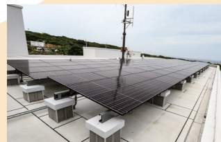
屋上太陽光パネル
