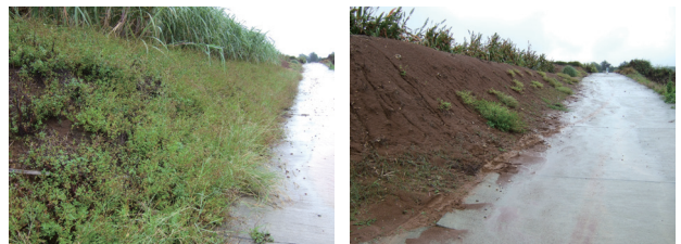
↑雑草が無い法面は、浸食し赤土が流出しているのが分かります。このような法面はもろくなりやすく、崩れる場合があります。
