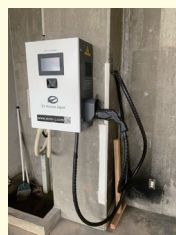
30kwの急速充電設備も併設
