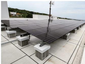
太陽光パネル
